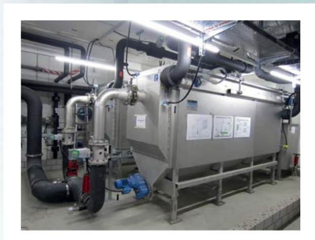
Abb. 4: Externer Wärmetauscher für die Abwärmenutzung aus Abwasser
