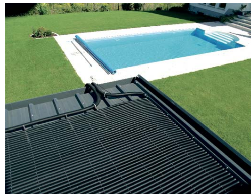
Abb. 9: Absorbermatten aus EPDM auf dem Dach zur Erwärmung des Badewassers
